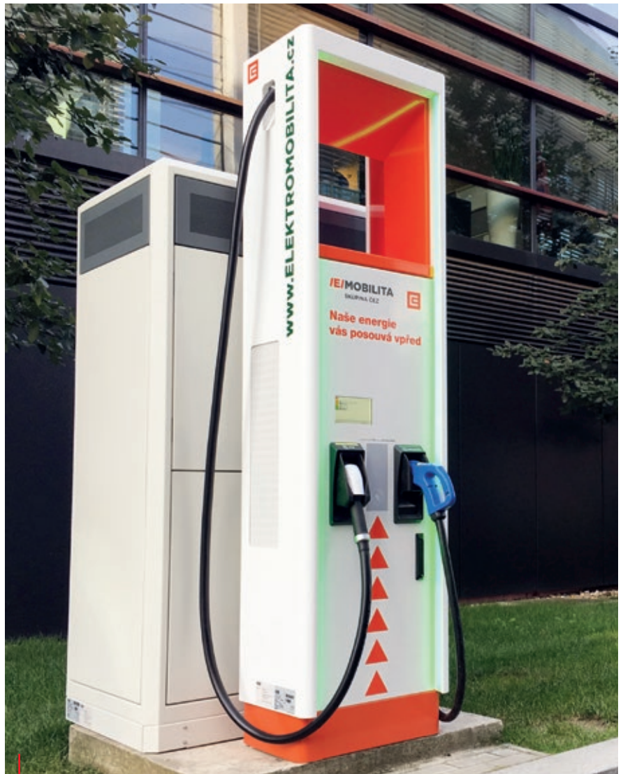
V pražské Duhové ulici zprovoznil ČEZ vysoce výkonný stojan, který umožňuje dobíjení výkonem až 150 kW.
